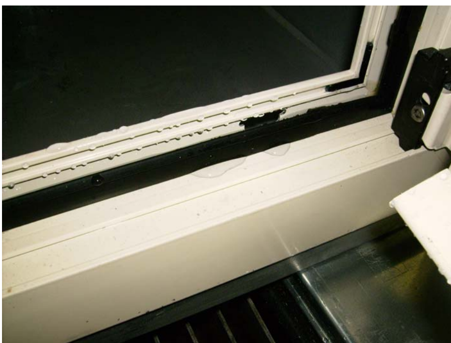
Foto 4: Perdite nella parte inferiore destra del campione dopo la prova di tenuta all'acqua
