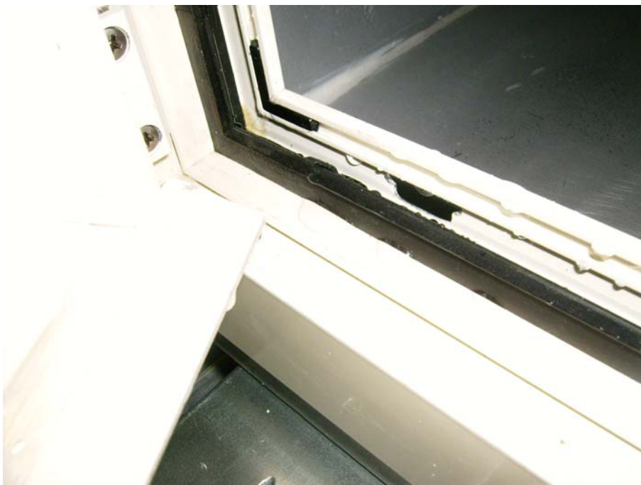
Foto 3: Perdite nella parte sinistra del campione dopo la prova di tenuta all'acqua
